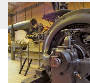
In der Maschinenhalle
